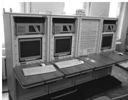
Рис. 7.2.14. Пульта контроля и управления АИС
